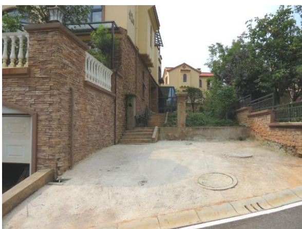
建筑物周边雨污管网
