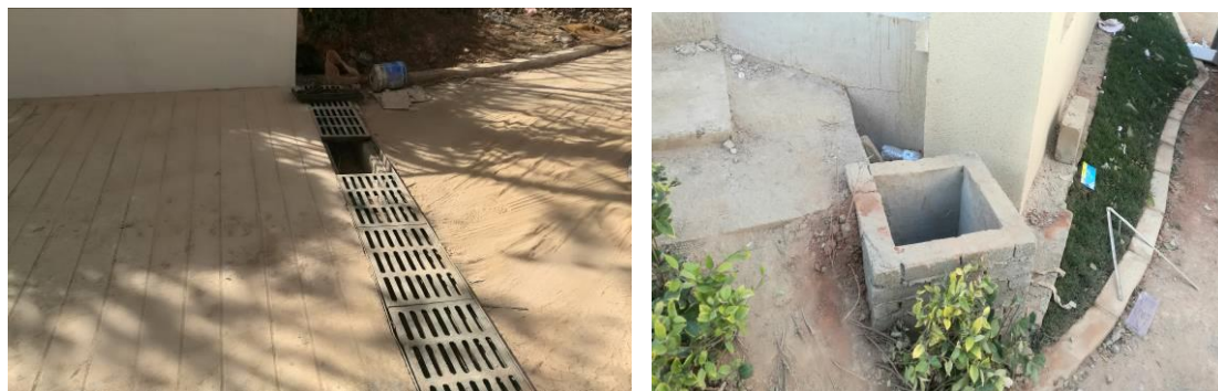
排水沟及沉淀池
